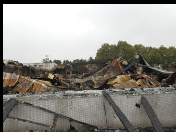
Piscine incendiée avec problématique amiante, métrés et prescriptions de déconstruction - Valenciennes
