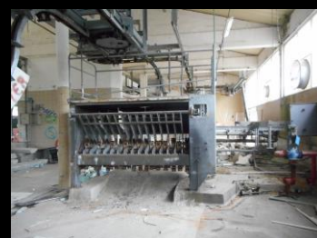
Déconstruction d'un abattoir, process vandalisé avec problématique amiante et terres polluées - Saint Lo
