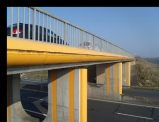
Méthodes de déconstruction d'un pont d'autoroute, travaux de nuit sous interruption de circulation - Amiens
